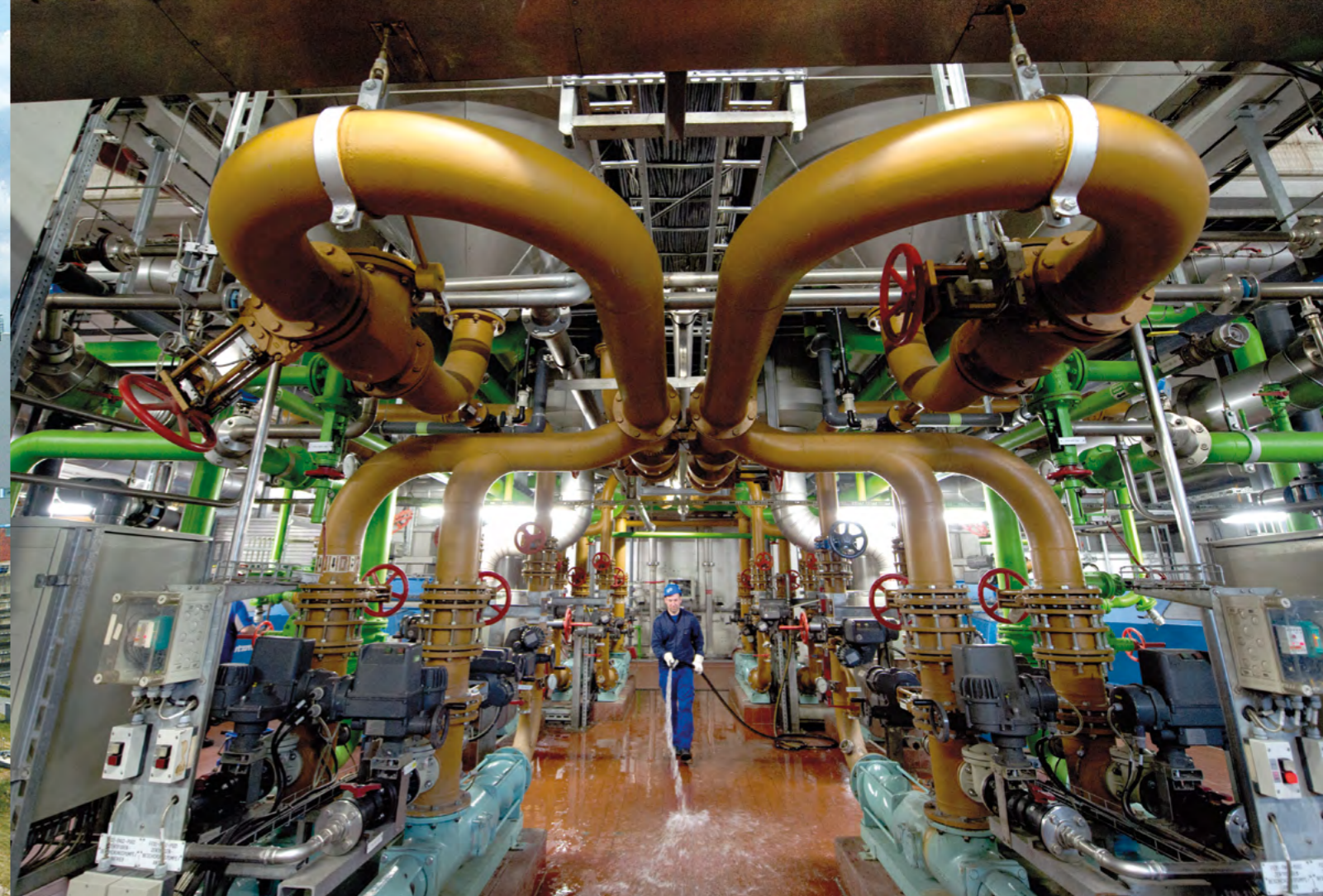
Oben: Blick auf die Anlagentechnik der VERA. Unten: Bevor seine Energie nutzbar gemacht werden kann, wird der Klärschlamm hier in der KETA (Klärschlamm-Entwässerungs- und Trocknungs-Anlage) getrocknet.
