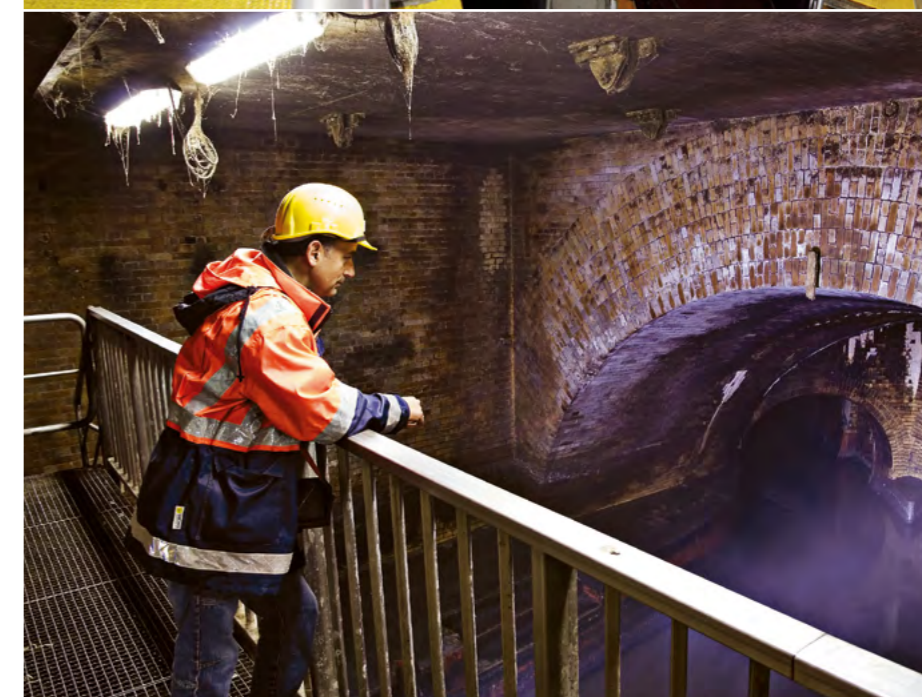
Oben: Sielschacht Sammler Flottbek. Unten: Das Fassungsvermögen der alten Transportsiele war bei großen Niederschlagsmengen trotz großer Querschnitte unzureichend.
