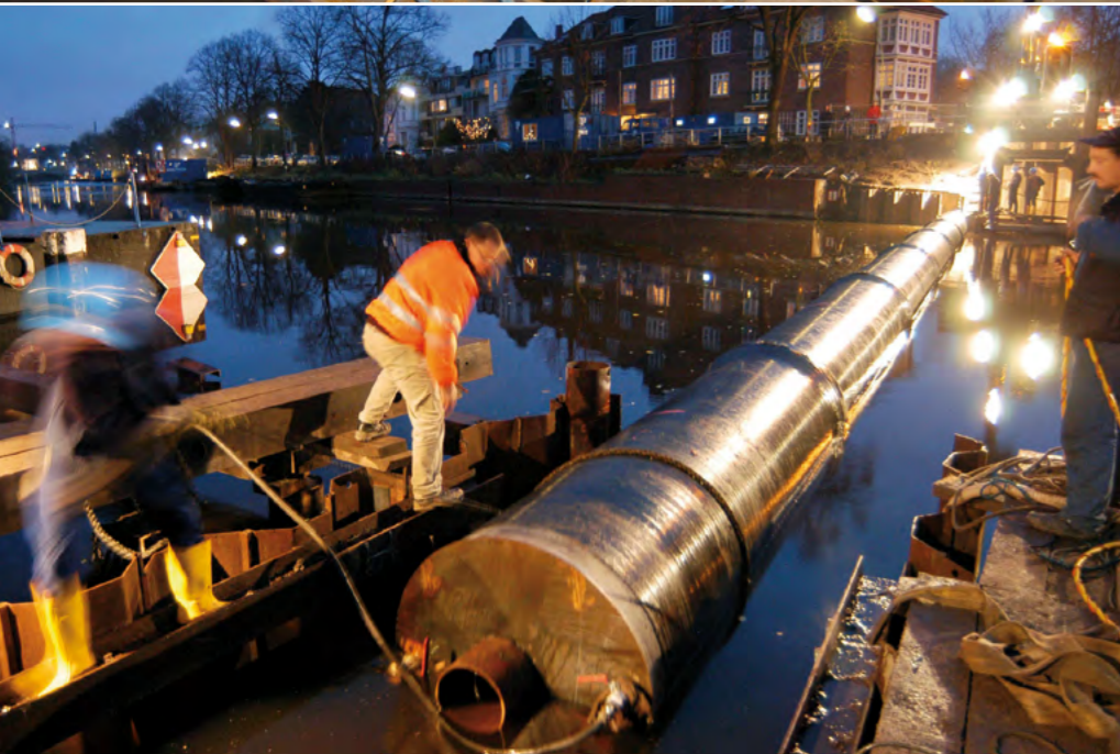
Dückerverlegung auf dem Grund eines Gewässers als Teil des Alster-Entlastungsprogramms. Ein Taucher verankert das Abwasserrohr unter Wasser.
