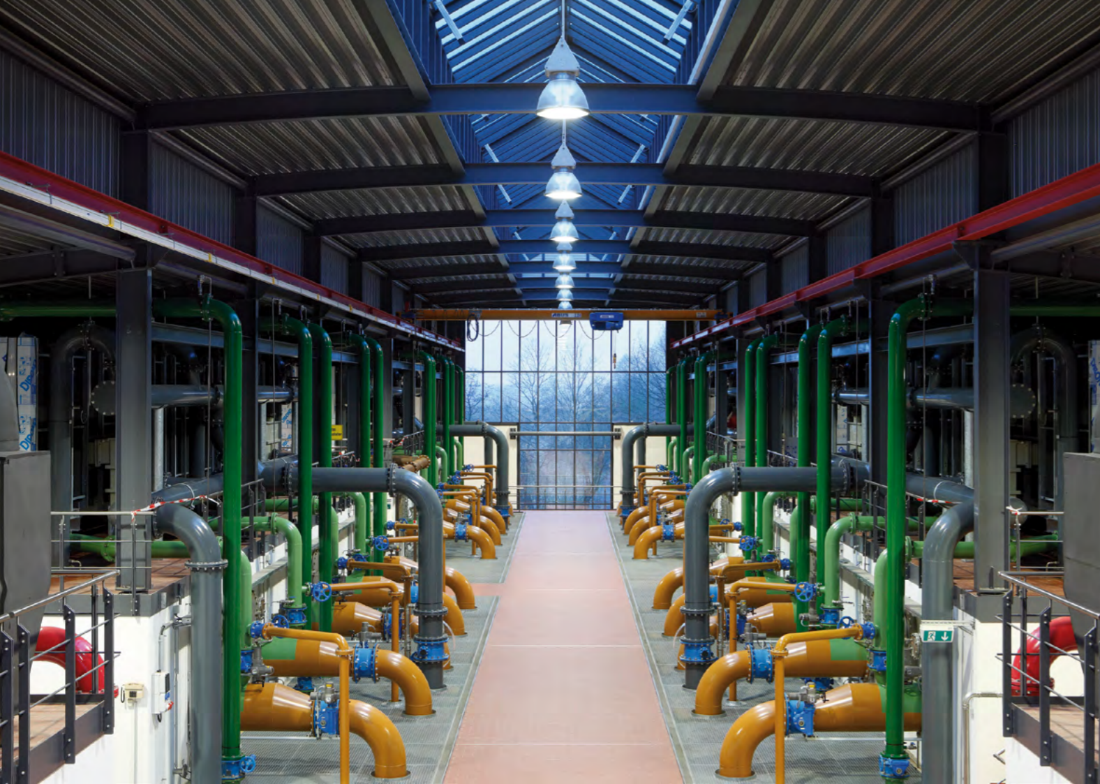
Filterhalle des Wasserwerks Curslack mit seinen beiden Filterstrecken mit jeweils zehn Schnellfiltern, die voneinander getrennt betrieben werden können.
