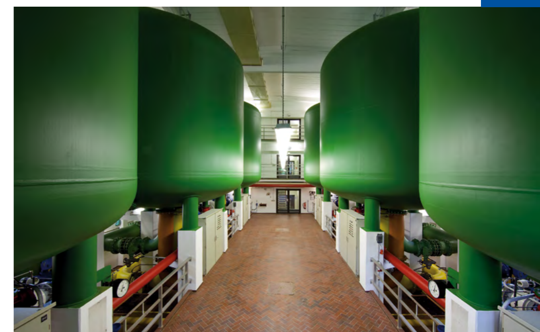
Die geschlossene Filteranlage hält Eisen- und Manganteilchen zurück, die über Rückspülungen wieder entfernt werden.
