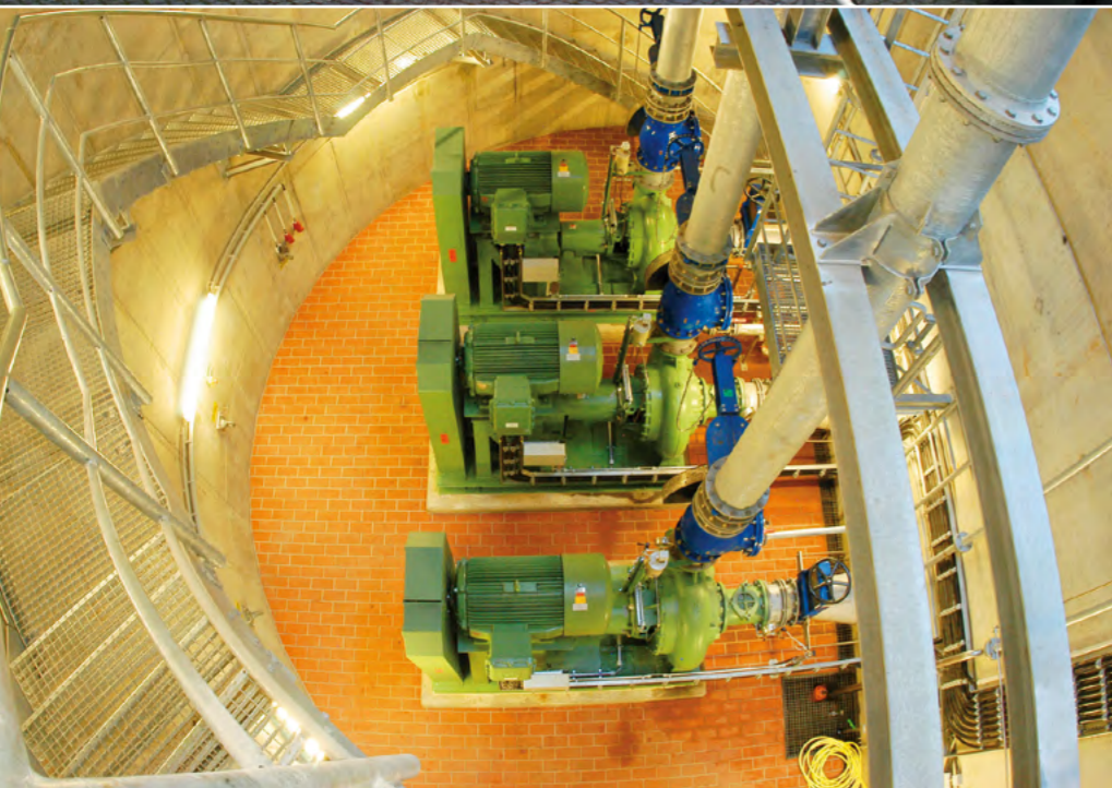
Oben: Einstieg zum Pumpwerk Anckelmannsplatz. Unten: Unter der Erdoberfläche befindet sich hochmoderne Pumpentechnik sowie ein Rückhaltebecken für 22.000 m 3 Mischwasser.
