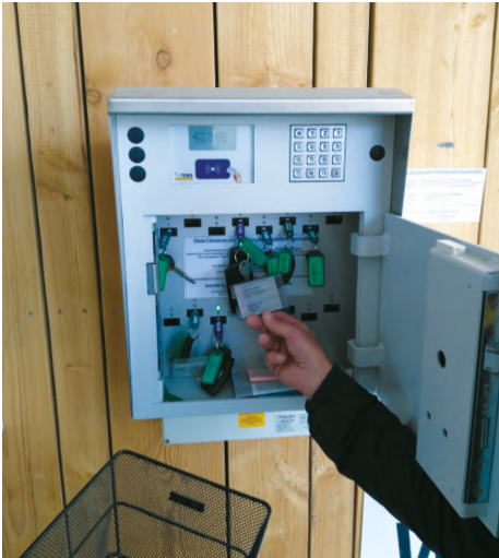
Abb. 48: Schlüsseltresor im Domagkpark in München, Willi Loose in bcs 2018d, S. 3
